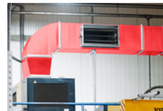
Eine Luftleitung verteilt die Abwärme der Kompressoren.
