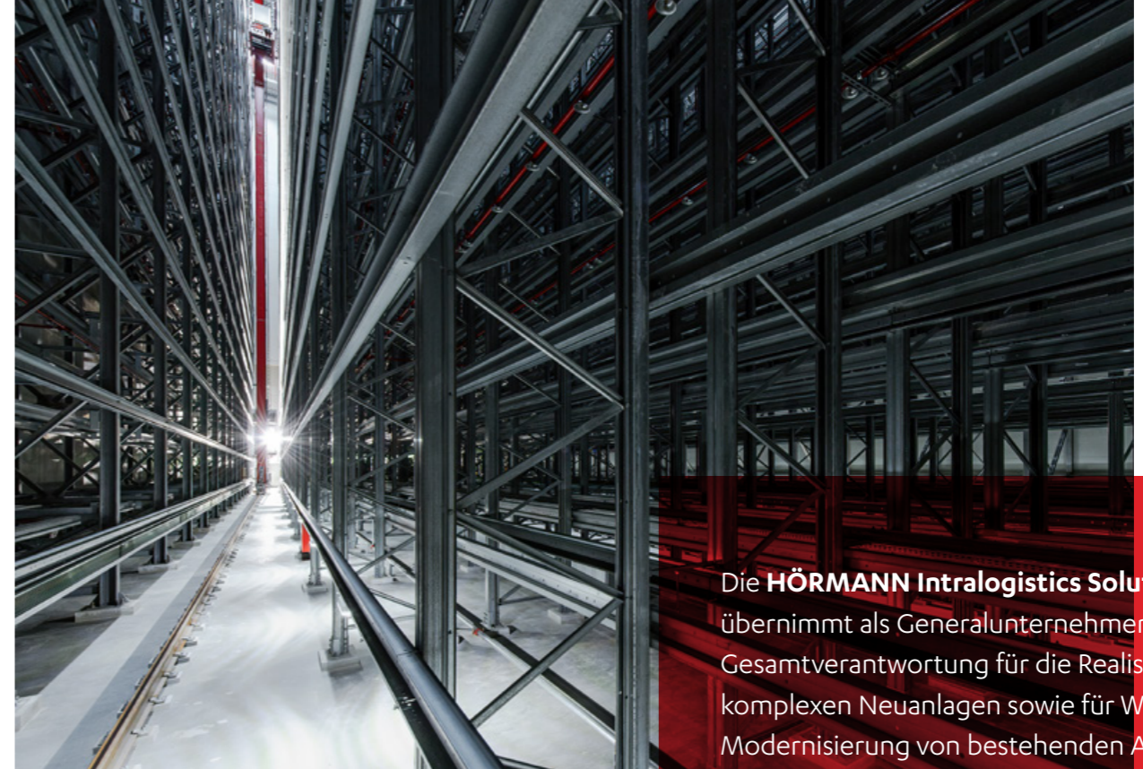
^ Das Hochregallager von innen
