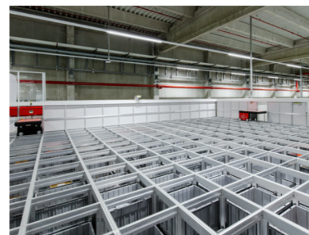
^ AutoStore®-Anlage für Kleinteile
